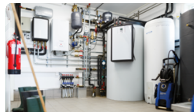
HØSTING AV VARME FRA KJØLING AV MELK
