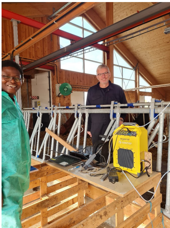
18.01.2021 Raphael Tabase og Geir Næss ved Nord universitet installerer metangassmålere i melkeffjøset på Mære. I forbindelse med prosjektet ZEC - Zero Emission Cowshed.
