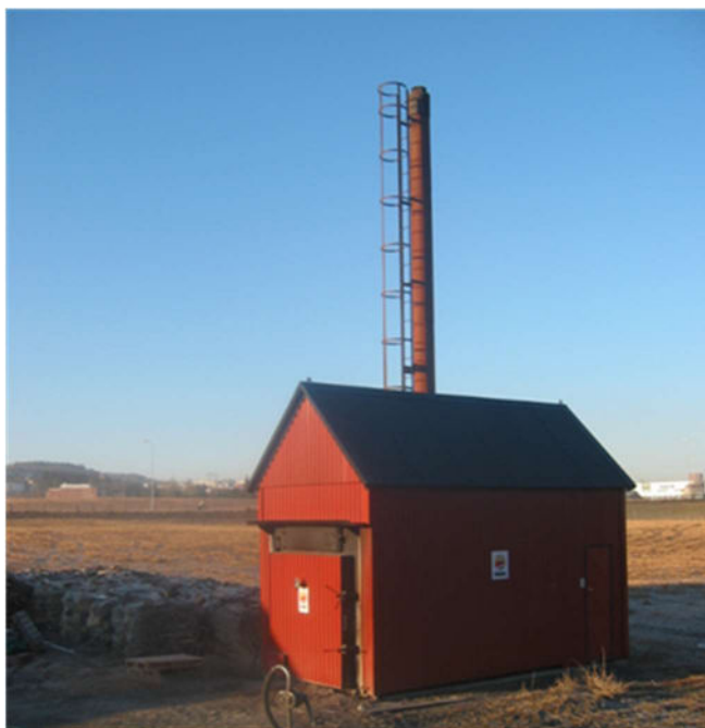
Figur 4-1 - Fyrsentral for utnyttelse av halm, energivirke m.m. Brukes bl.a. til oppvarming av anlegg for kyllingproduksjon. (Foto: Lars Bugge)
